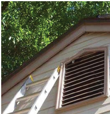
REJILLAS DE VENTILACIÓN SIN PANTALLA
